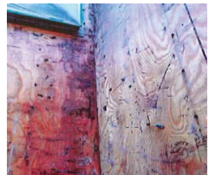
外壁内部の雨漏りの跡 (修補工事のため外壁をはがした状態)
